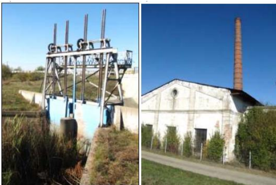
7-8. fénykép A Kismajtényi régi gőzüzemű szivattyútelep épülete (bal), a Tagyi zsilip (jobb)
